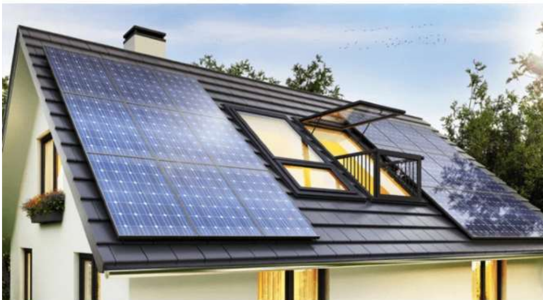
Фигура 3.14. Фотоволтаични панели, монтирани на покрива на сградата.
