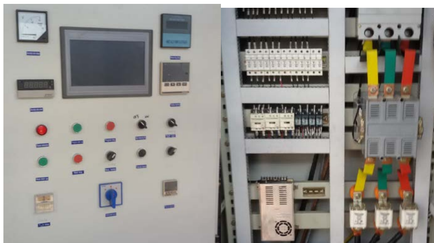
Фиг. 2.13. Контролер на пещта(в ляво) и шкаф и табло на контролера(в дясно)
