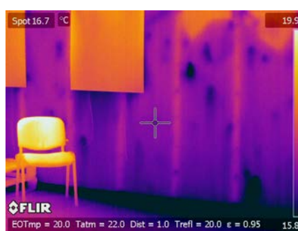
Фиг.71: Дефекти в топлоизолация
