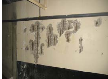
Фиг. 5: Корозия на армировка
