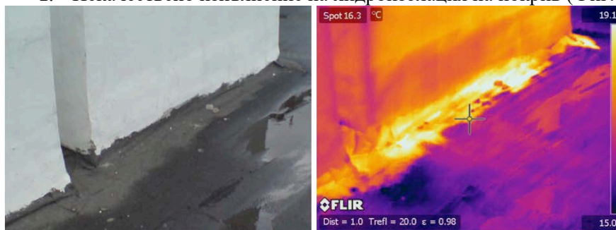
Фиг.67: Компрометирана хидро и топлоизолация на покрив
