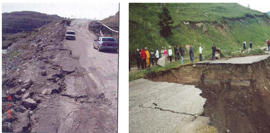
Фиг. 89. Изглед на път, след свлячище.
